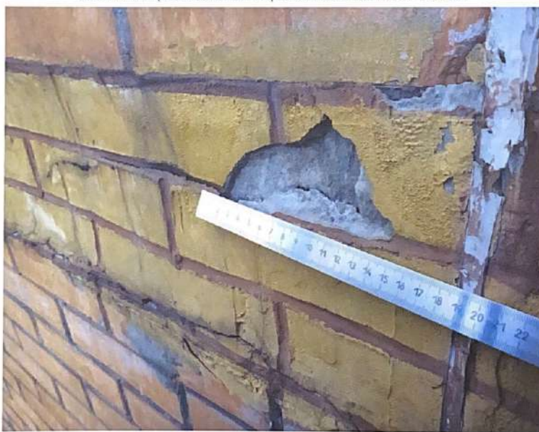
Фото 157. Секция 11/12. Фасад №2. Разрушение участков ранее выполненного ремонта. Отсутствие деформационных швов.
