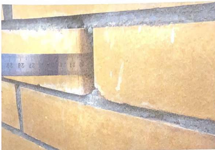
Фото 158. Секция 11/12. Фасад №2. Дефекты кладки- пустошовка. Полное отсутствие защиты от атмосферных воздействий.
