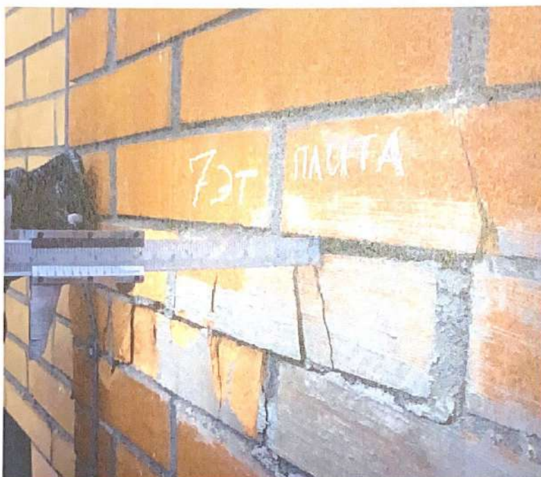
Фото 105. Секция 11. Фасад 2. Разрушения облицовки плиты. Деформационный шов отсутствует. Свес кирпича – 52мм.
