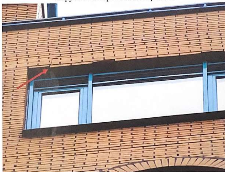
Фото 68. 807 Секция 9. Фасад 1. Разрушение кладки над оконной балкой, вызванное нерасчетной ее деформацией. Обрушение карнизного кирпича. Отсутствие деформационного шва.
