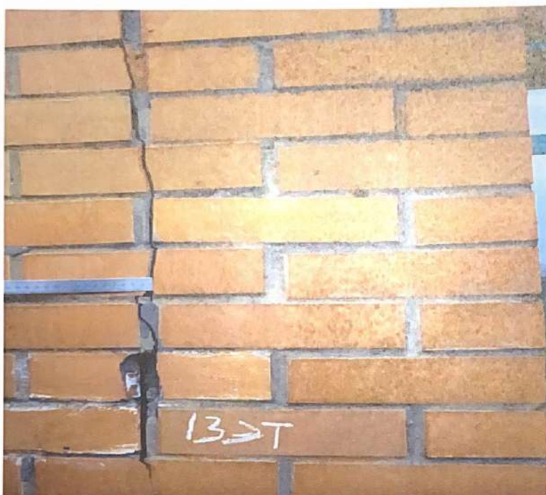
Фото 55. Секция 9. Фасад 1. Критическое повреждение наружной версты – вертикальная трещина с раскрытием 7мм.
