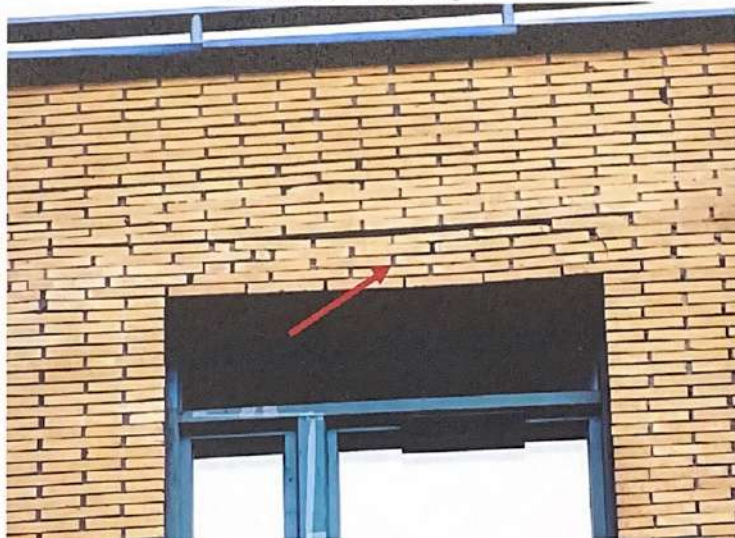
Фото 171. Секция 12. Ось E22. Разрушение кладки над оконной балкой.
