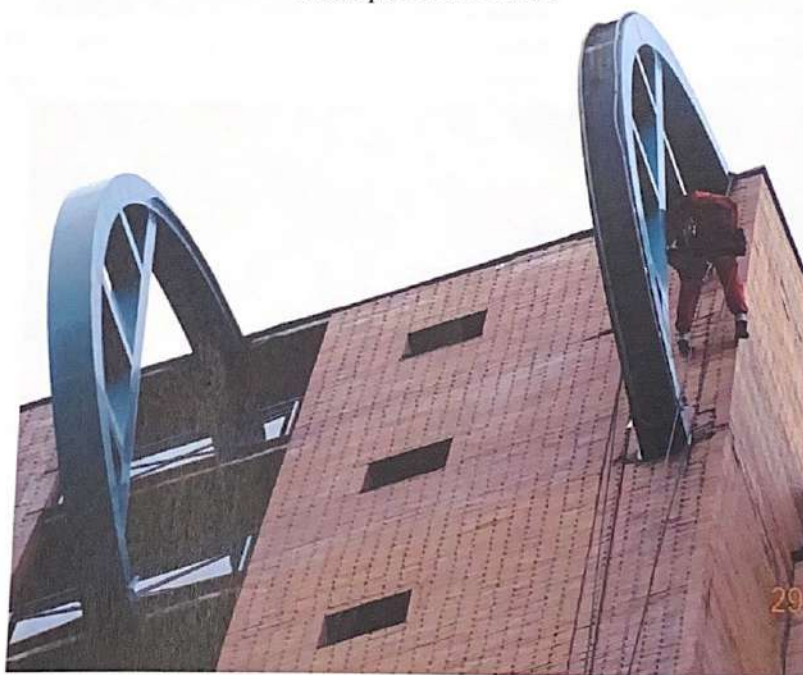
Фото 42. Секция 9. Фасад 1. Критические поверхностные разрушения кирпича зоны примыкания металлоконструкций. Обследование фасада подъездного выступа альпинистами.
