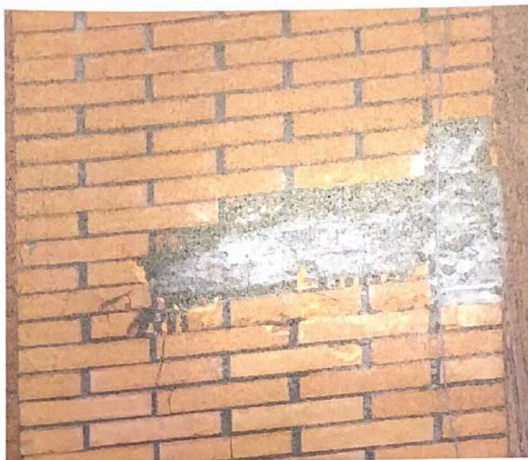
Фото 133/814 Секция 11. Фасад 2. 8-й эт. Разрушение кладки по месту плиты перекрытия.
