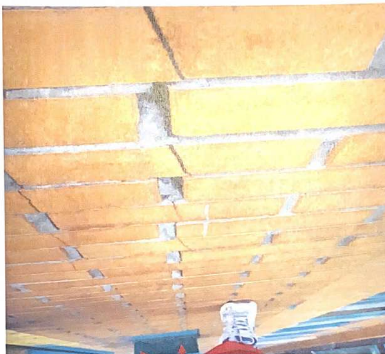
Фото 81. Секция 11. Фасад 2. Дефекты швов кладки-пустошовка. Вертикальные трещины в зоне примыкания металлоконструкций.
