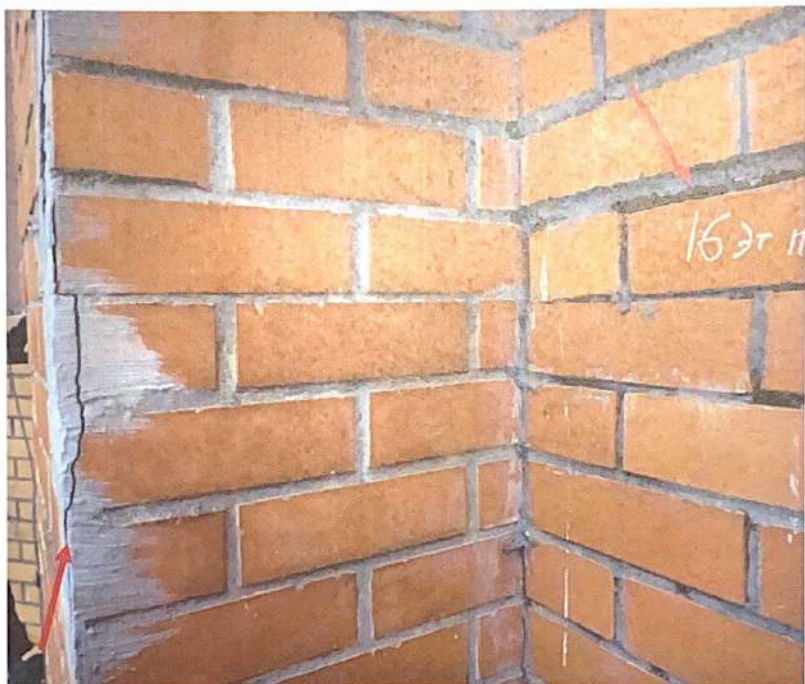
Фото 99. Секция 11. Фасад 2. Деформации по участку ремонта повреждений. Пустошовка облицовки плиты.
