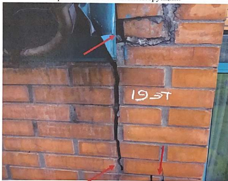
Фото 50. Секция 9. Фасад 1. Критическое повреждение наружной версты зоны примыкания металлоконструкций. Трещина развивается под металлоконструкцию.
