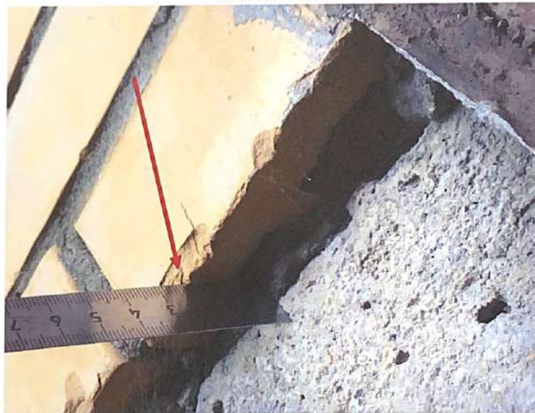
Фото 161. Секция 11/12. Фасад №2. Сверхнормативный свес опорного кирпича – 25мм.
