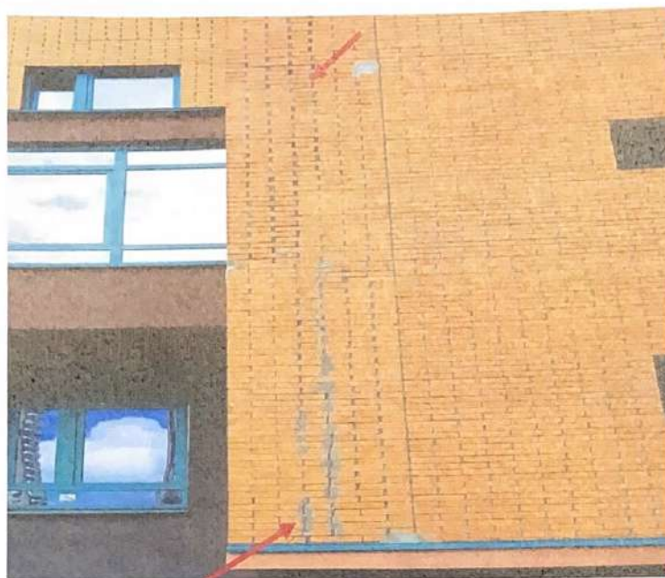
Фото 166. Секция 12. Фасад 2. Трансэтажные вертикальные трещины по левой стороне подъездного выступа. Раскрытие трещин на участках ранее выполненных ремонтов.
