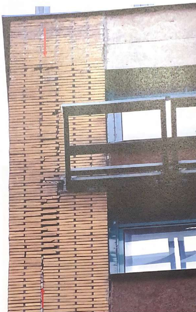
Фото 139/812. Секция 11/12. Фасад №2 Разрушение кирпичной кладки по линии деформационного шва, в связи с обрывом деформационного шва на уровне окна 20-го этажа.
