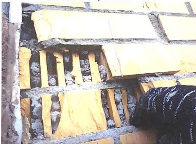
Фото 80. Секция 11. Фасад 2. Разрушение кирпича в парапетной зоне.
