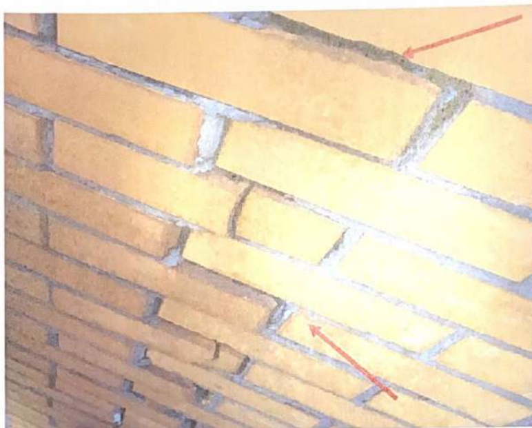
Фото 154. Секция 11/12. Фасад №2. Линия разрушения кладки по линии межсекционного деформационного шва. Полное отсутствие защиты от атмосферных воздействий. Критическое смещение частей кладки наружу в двух плоскостях, сквозное разрушение швов и кирпича.
