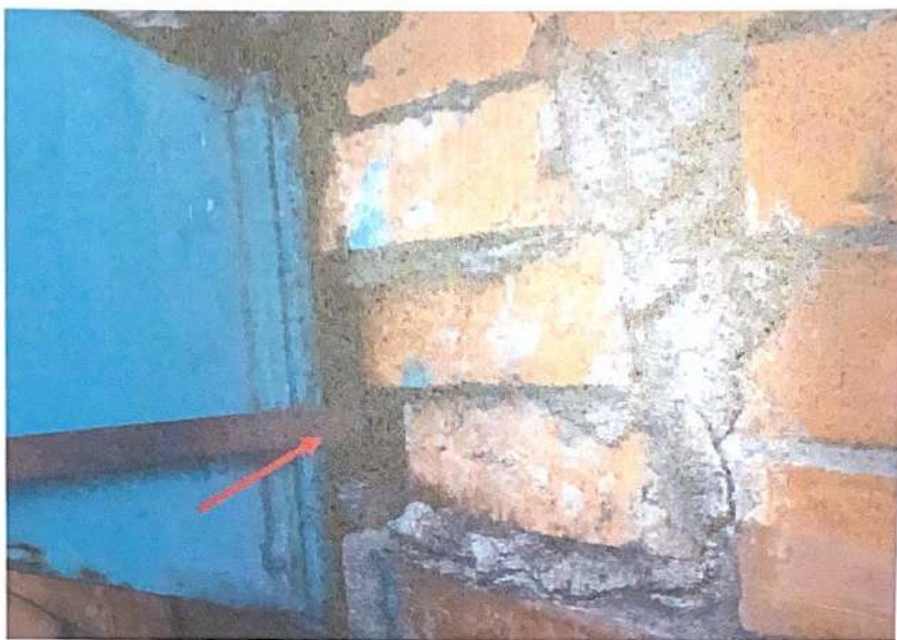
Фото 51. Секция 9. Фасад 1. Критическое повреждение наружной версты зоны примыкания металлоконструкций. Деформационный шов отсутствует, защиты от проникновения атмосферных осадков нет.
