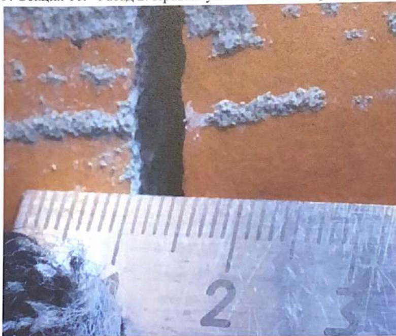
Фото 110. Секция 11. Фасад 2. Вертикальная трещина с раскрытием до 5мм.
