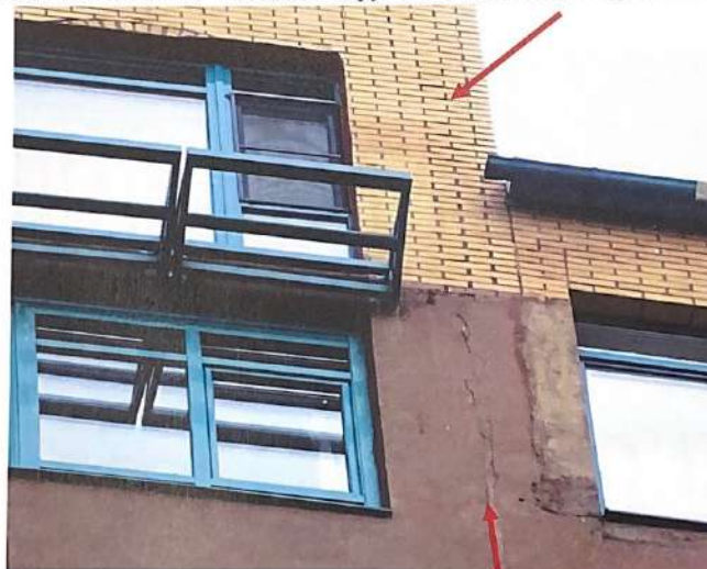
Фото 34. 787 Секция 8,9 . Фасад 1. Межсекционный деформационный шов не доходит до верха здания – причина разрушения вышележащей кладки.
