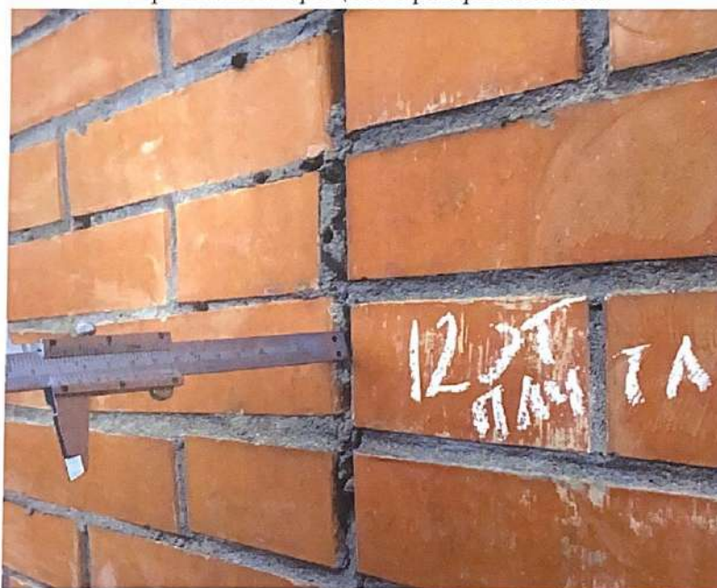
Фото 56. Секция 9. Фасад 1. Обследование зоны плиты перекрытия – свес кладки достигает 68мм. Деформационный шов отсутствует.
