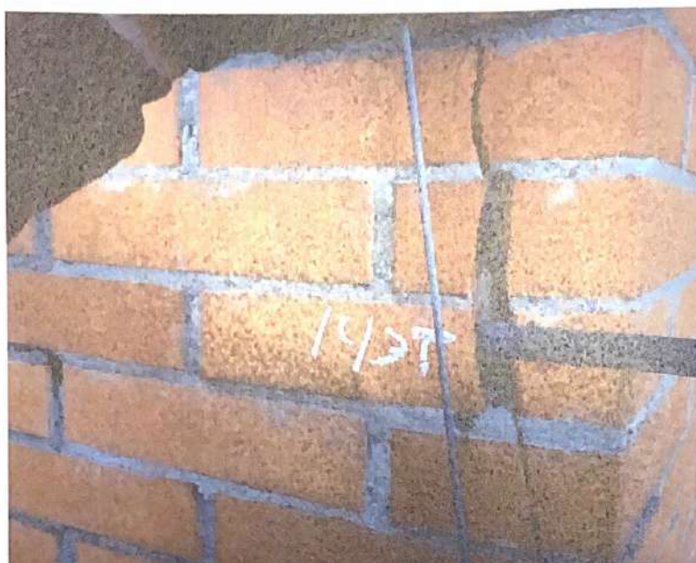
Фото 127. Секция 11. Фасад 2 Разрушение облицовки плиты. Вертикальная трещина с раскрытие 4мм. Местное разрушение кирпича.
