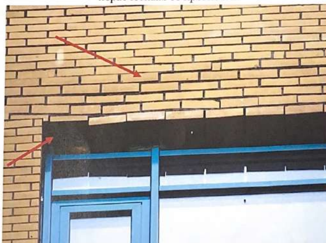
Фото 36. 790 Секция 9. Фасад 1. Разрушение кладки над оконной балкой, вызванное нерасчетным ее прогибом.
