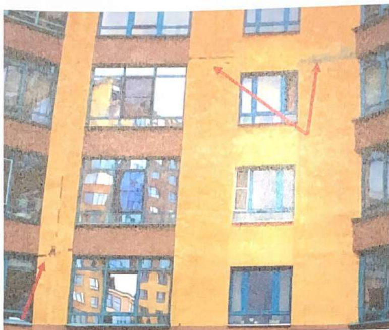
Фото 182. Секция 9/10. Фасад 3. Разрушения по линии межсекционного деформационного шва. Разрушения по линиям плит перекрытия. Участки ранее выполненного ремонта. Деформационные швы не выполнены.
