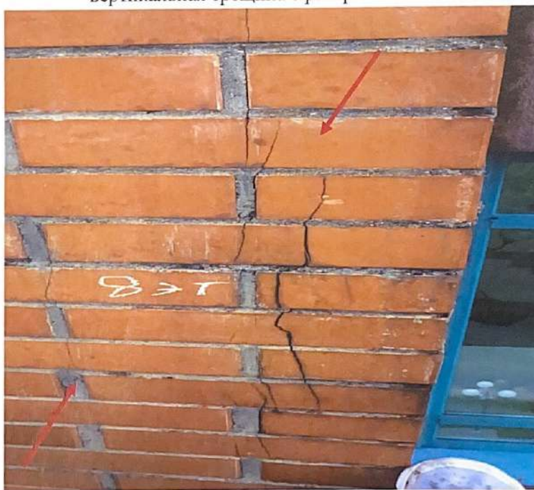
Фото 58. Секция 9. Фасад 1. Критическое повреждение наружной версты – вертикальная трещина с раскрытием 6мм.
