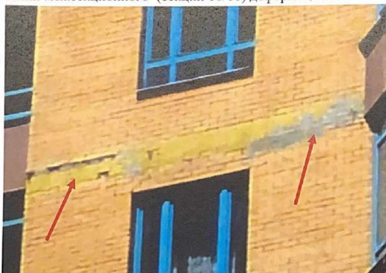
Фото 181. Секция 10. Разрушения по линиям плит перекрытия. Участки ранее выполненного ремонта. Деформационные швы не выполнены.
