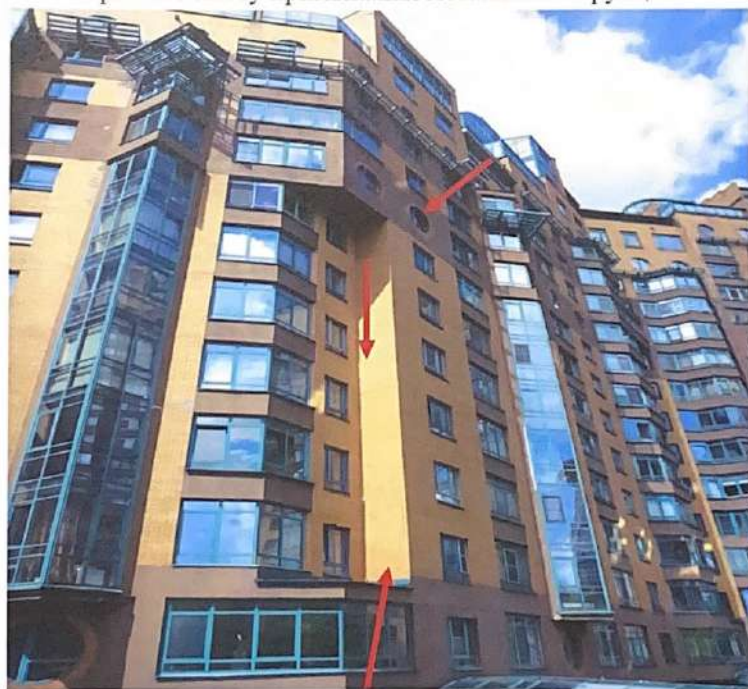
Фото 185. Секция 7. Трансэтажные вертикальные трещины по наружной версте. Диагональные трещины пересекающие кружальную кладку круглых окон.
