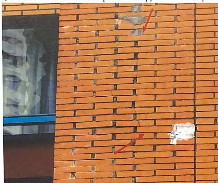
Фото 165. Секция 12. Фасад 2. Трансэтажные вертикальные трещины по левой стороне подъездного выступа. Дефекты исходной кладки – пустошовка, сверхнормативные швы являются признаком нарушения геометрии кладки.
