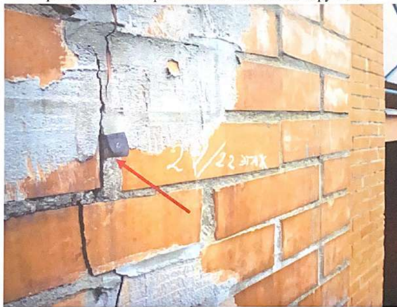
Фото 84. Секция 11. Фасад 2. Деформации по месту ремонта повреждений. Сквозные вертикальные трещины
