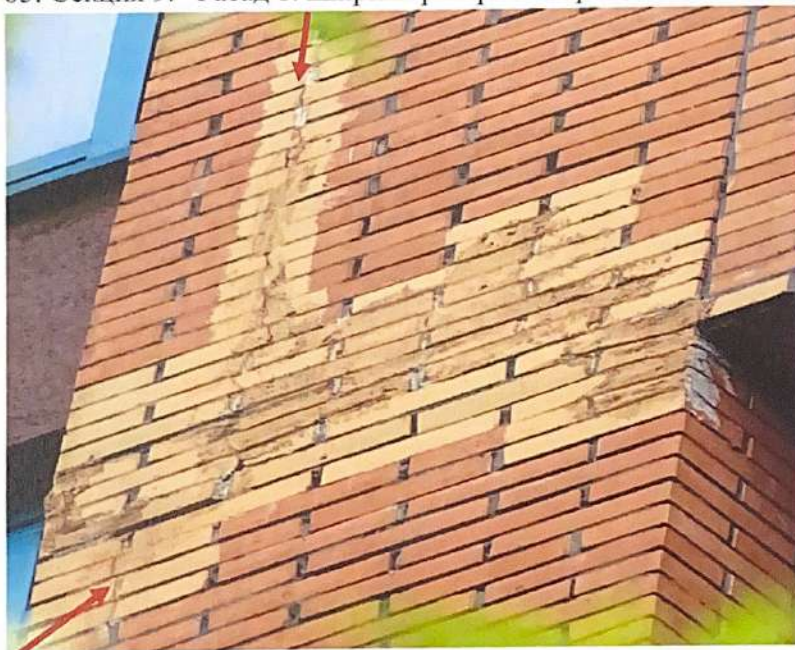
Фото 66. 801 Секция 9. Фасад 1. Места восстановления имеют значительные поверхностные повреждения. Деформационный шов не выполнен.
