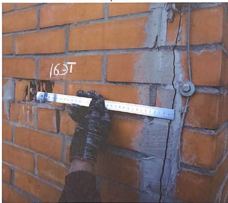
Фото 122. Секция 11. Фасад 2. Разрушение облицовки плиты. Вертикальная трещина с раскрытие 4мм.
