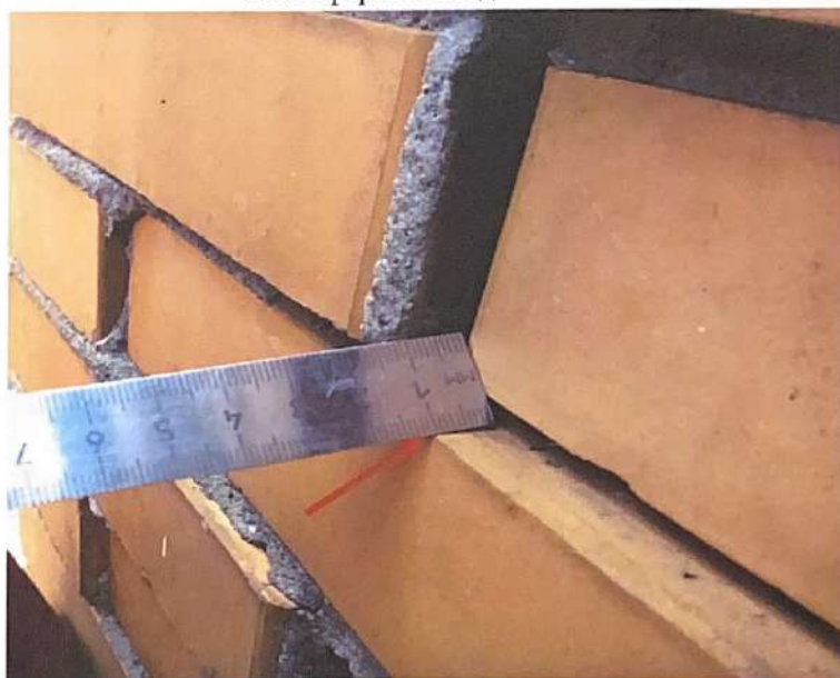
Фото 149. Секция 11/12. Фасад №2. Разрушение кладки по линии межсекционного деформационного шва. Отсутствие деформационных швов. Полное отсутствие защиты от атмосферных воздействий.
