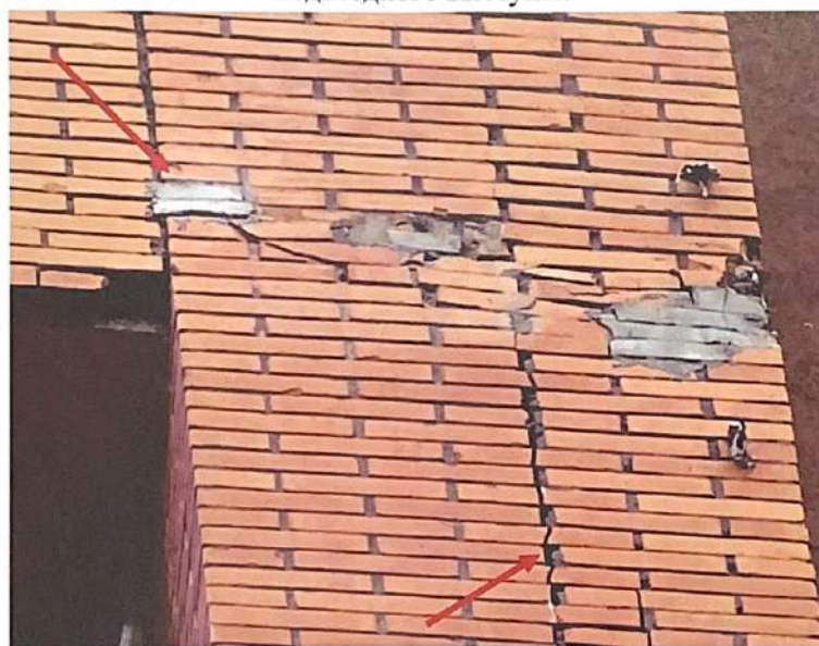
Фото 132. Секция 11. Фасад 2. Трансэтажная трещина. Разрушение кладки по месту выполненного ремонта. Разрушение кирпича.
