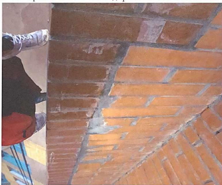
Фото 92. Секция 11. Фасад 2. Участок восстановления кирпичной кладки фасада- значительных повреждений не выявлено.Повторен дефект – облицовка плиты перекрытия.
