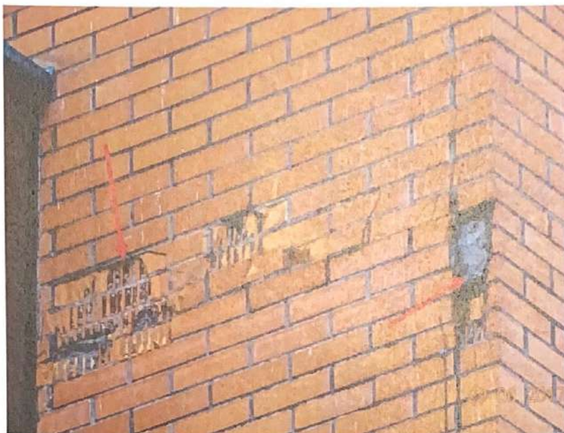
Фото 75. 148 Секция 10. Фасад 2. Критические разрушения фасада. Трансэтажная вертикальная трещина. Разрушение облицовки торца плиты. Отсутствие деформационного шва.
