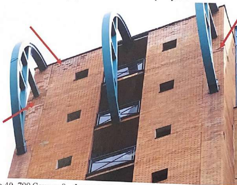
Фото 40. 799 Секция 9. Фасад 1. Критические поверхностные разрушения кирпича подпарапетной зоны и зоны примыкания металлоконструкций. Проектный козырек отсутствует.
