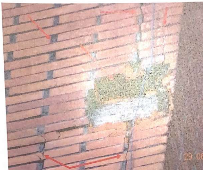
Фото 123. 144 15-й эт. Секция 11. Фасад 2. Разрушение облицовки плиты. Свес плиты 65мм. по обеим плоскостям.
