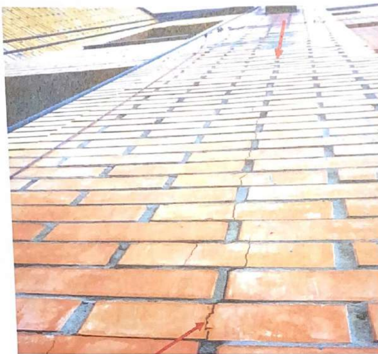
Фото 87. Секция 11. Фасад 2. Дефекты швов кладки-пустошовка, сверхнормативные вертикальные швы.. Трансэтажные вертикальные трещины.
