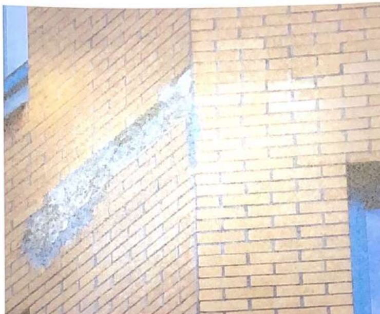
Фото 176. Секция 11. Разрушения по линиям плит перекрытия. Сверхнормативный свес опорного кирпича ~ 45мм.
