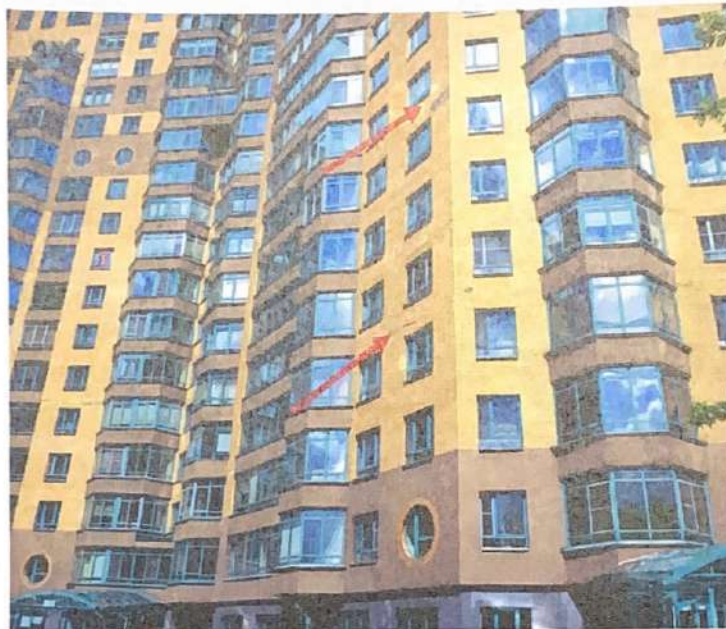
Фото 174. Секция 11. Ось E13. Разрушения по линиям плит перекрытия.
