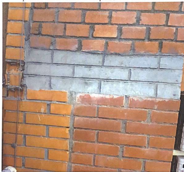
Фото 94. Секция 11. Фасад 2. Участок восстановления кирпичной кладки фасада- значительных повреждений не выявлено. Торец плиты оштукатурен. Деформационный шов не выполнен.
