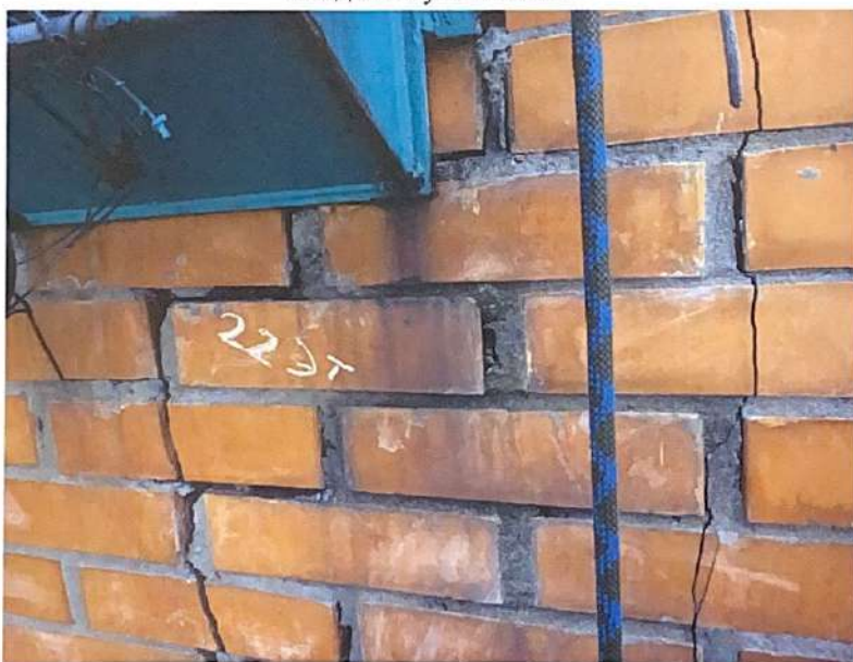
Фото 112. Секция 11. Фасад 2. Правый угол. Разрушение кладки в зоне примыкания металлоконструкций.
