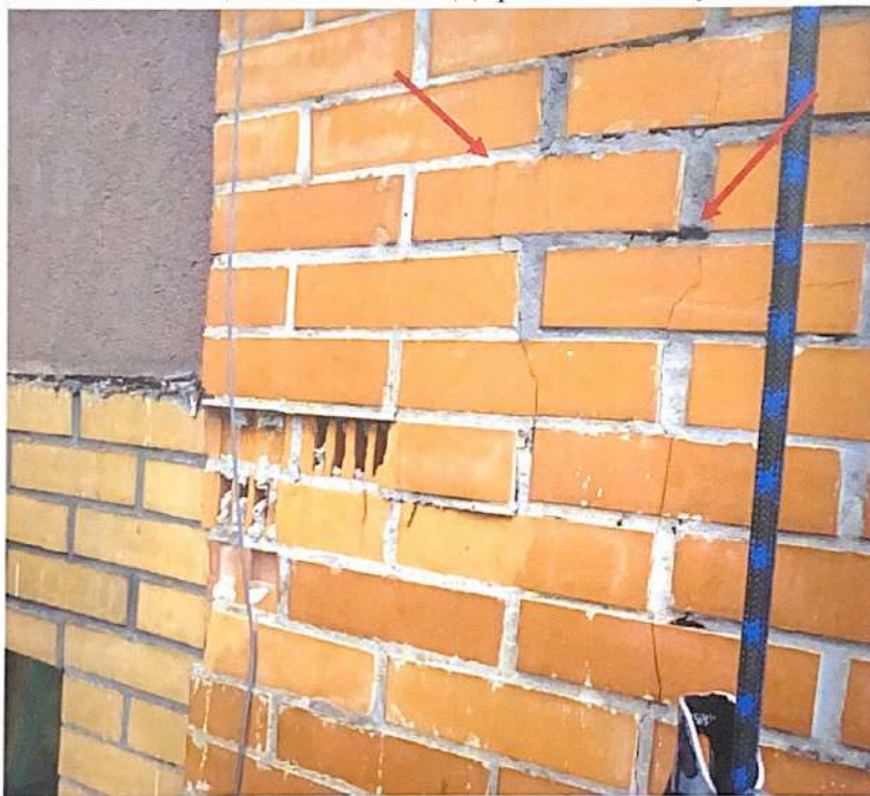
Фото 98. Секция 11. Фасад 2. Разрушение облицовки плиты. Вертикальные трещины по левой стороне подъездного выступа.
