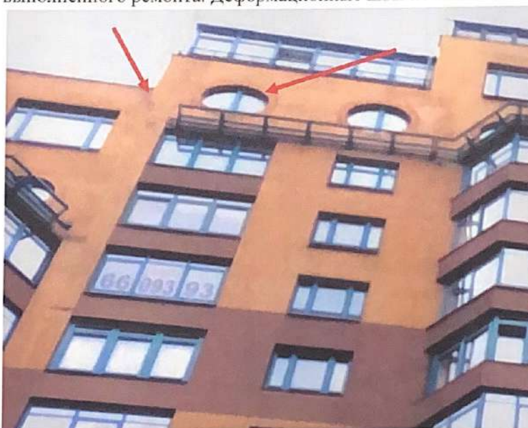
Фото 183. Секция 8/9. Разрушения по линии межсекционного деформационного шва. Диагональные трещины с нарушением целостности кружальной кладки круглых окон.
