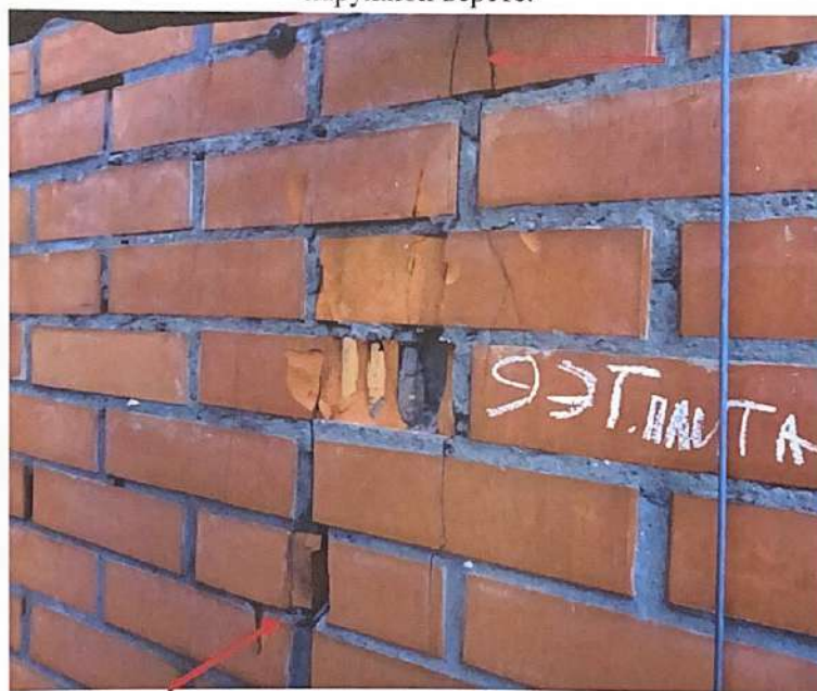
Фото 130. Секция 11. Фасад 2. Вертикальная трещина по наружной версте. Разрушение облицовки торца плиты.
