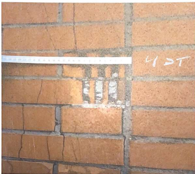
Фото 63. Секция 9. Фасад 1. Обширное разрушение кирпичной кладки. По направлению развития вертикальной трещины.
