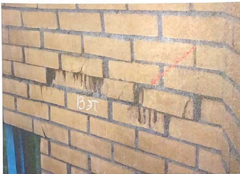
Фото 101. Секция 11. Фасад 2. Разрушения облицовки плиты. Деформационный шов отсутствует. Пустошовка.
