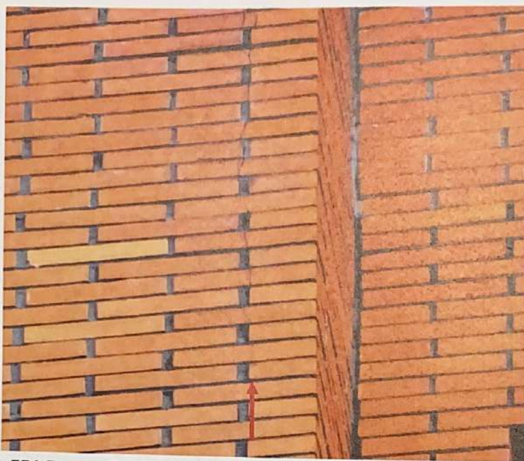
Фото 27. 776 Секция 7. Фасад 1. Вертикальные трещины по наружное версте.
