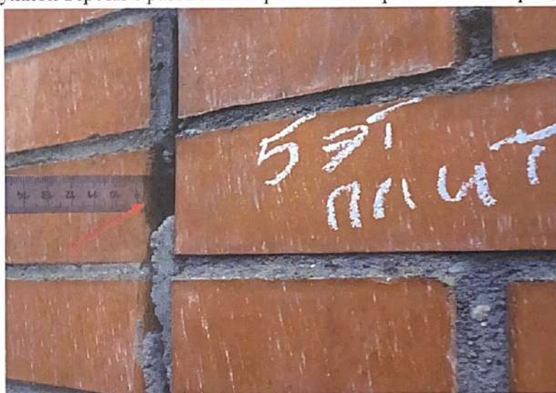
Фото 62. Секция 9. Фасад 1. Обследование зоны плиты перекрытия – свес кладки достигает 86мм.
