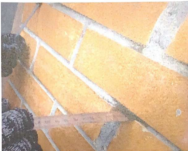
Фото 97. Секция 11. Фасад 2. Дефекты швов- пустошовка.
