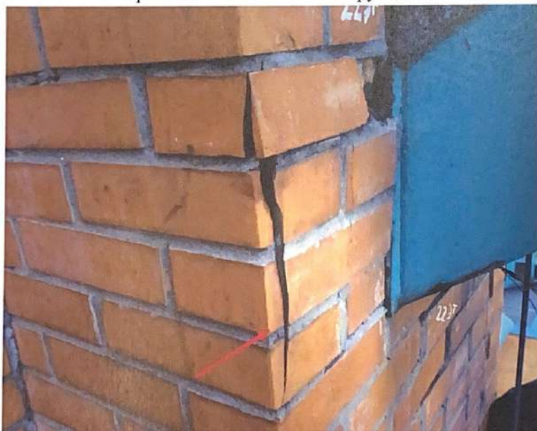
Фото 114. Секция 11. Фасад 2. Правый угол. Разрушение кладки в зоне примыкания металлоконструкций.
