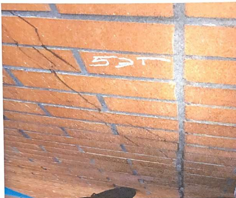
Фото 61. 5-й эт. Секция 9. Фасад 1. Диагональные трещины смещения кладки наружной версты с развитием вертикальной трансэтажной трещины.
