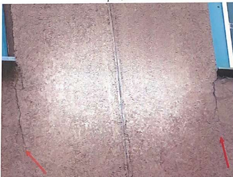
Фото 38. 793 Секция 9. Фасад 1. Диагональные трещины от углов окон.
