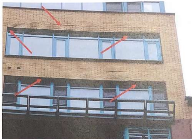
Фото 35. Секция 9. Фасад 1. Разрушение кладки над оконной балкой, вызванное нерасчетным ее прогибом.
