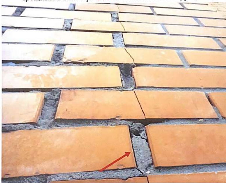
Фото 82. Секция 11. Фасад 2. Дефекты швов кладки-пустошовка. Вертикальные трещины в зоне примыкания металлоконструкций.
