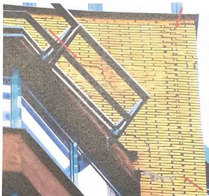
Фото 172. Секция 12/11. Ось E22. Критическое разрушение кладки по линии межсекционного деформационного шва.
