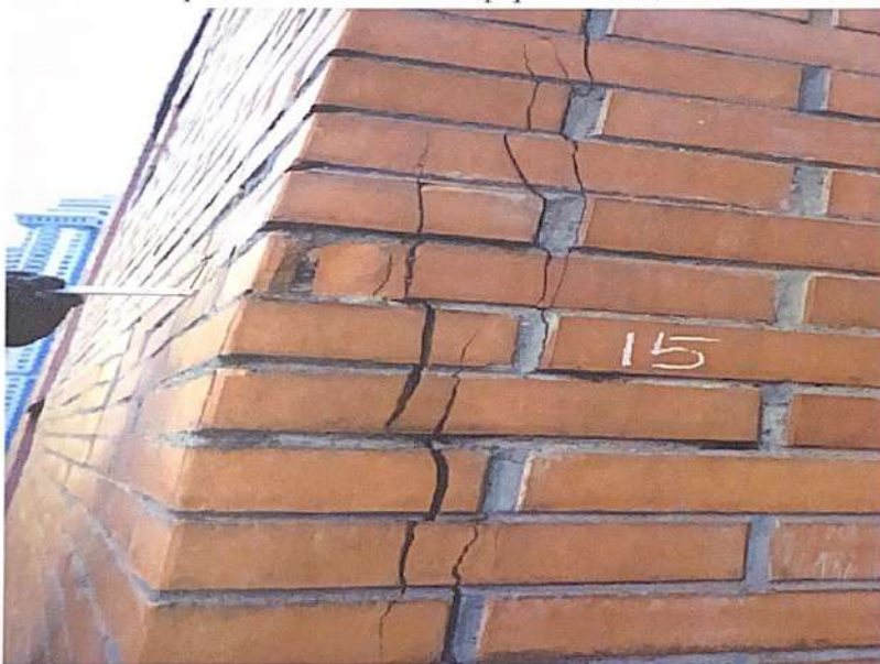
Фото 52. 804 Секция 9. Фасад 1. Вертикальные трещины по правой боковой поверхности пдъездного выступа.
