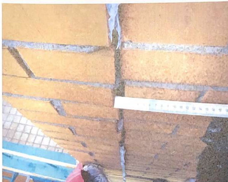
Фото 156. Секция 11/12. Фасад №2. Фасад №2. Линия межсекционного деформационного шва. Полное отсутствие защиты от атмосферных воздействий. Межсекционное смещение составляет 20мм.
