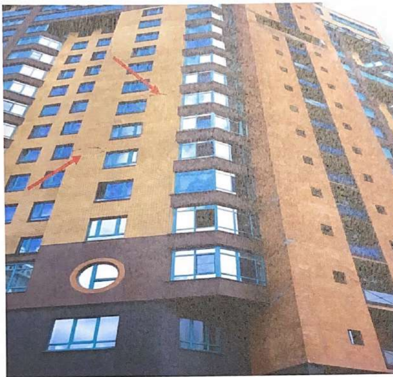
Фото 69. 240/761 Секция 9. Фасад 1. Разрушения облицовки торца плиты.
