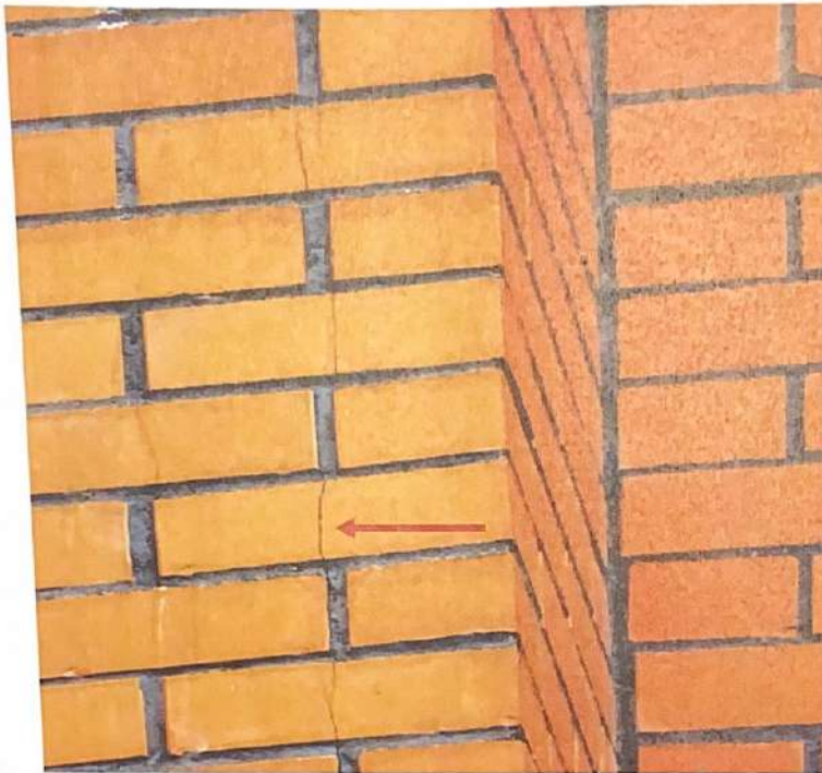
Фото 29. 779 Секция 7. Фасад 1. Вертикальные трещины по наружное версте.
