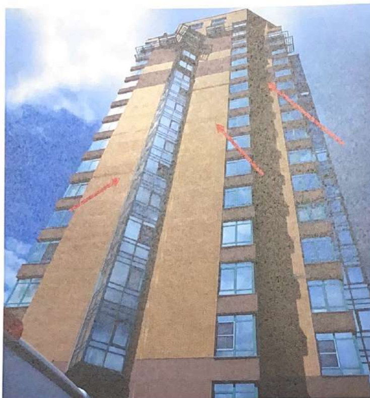
Фото 168. Фасад по оси F1. Разрушения облицовки торцов плит.
