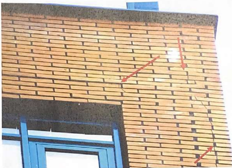
Фото 37. 792 Секция 9. Фасад 1. Разрушение кладки над оконной балкой, вызванное нерасчетным ее прогибом. Секция 8,9 . Фасад 1. Межсекционный деформационный шов не доходит до верха здания – причина образования трещин.
