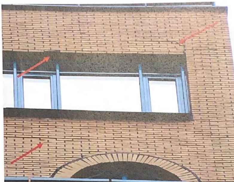
Фото 67. 806 Секция 9. Фасад 1. Разрушение кладки над оконной балкой, вызванное нерасчетной ее деформацией. Разрушения облицовки торца плиты. Обрушение карнизного кирпича.
