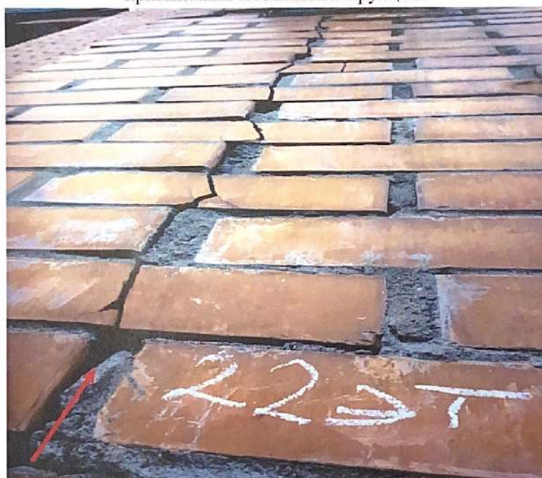
Фото 116. Секция 11. Фасад 2. Правый угол. Разрушение кладки в зоне примыкания металлоконструкций.
