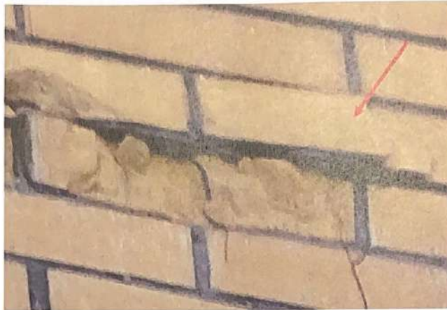
Фото 33. Секция 8. Фасад 1. Разрушение облицовки торца плиты.
