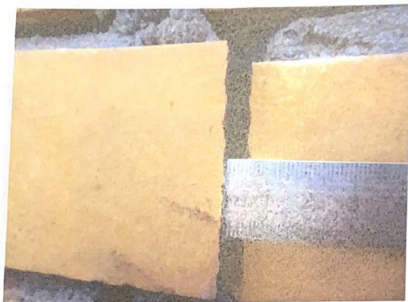
Фото 144. Секция 11/12. Фасад №2. Разрушение кладки по линии межсекционного деформационного шва. Смещение в двух плоскостях, сквозное разрушение швов и кирпича.
