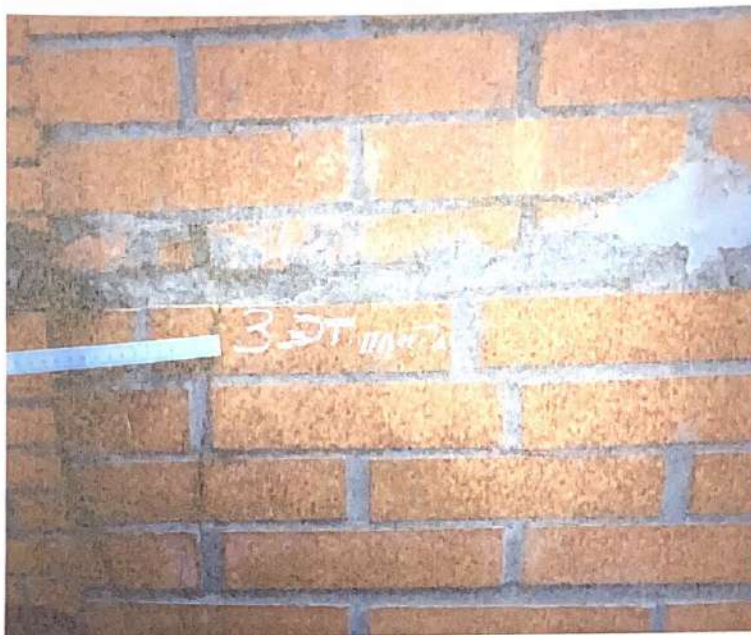
Фото 137. Секция 11. Фасад 2. Вертикальная трещина по наружной версте с раскрытием 4 мм. Сверхнормативные горизонтальные швы. Пустошовка.
