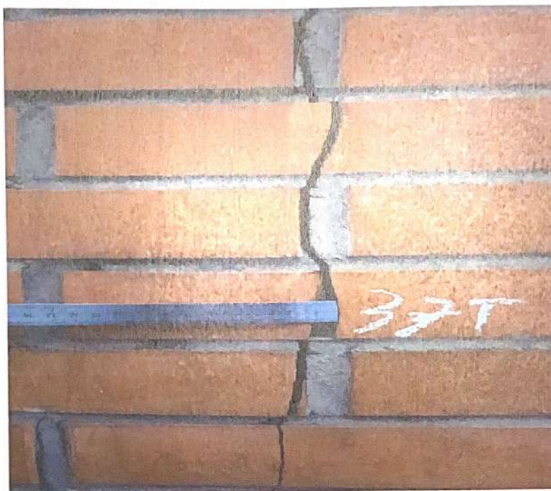
Фото 65. Секция 9. Фасад 1. Ширина раскрытия трещины достигает 7мм.
