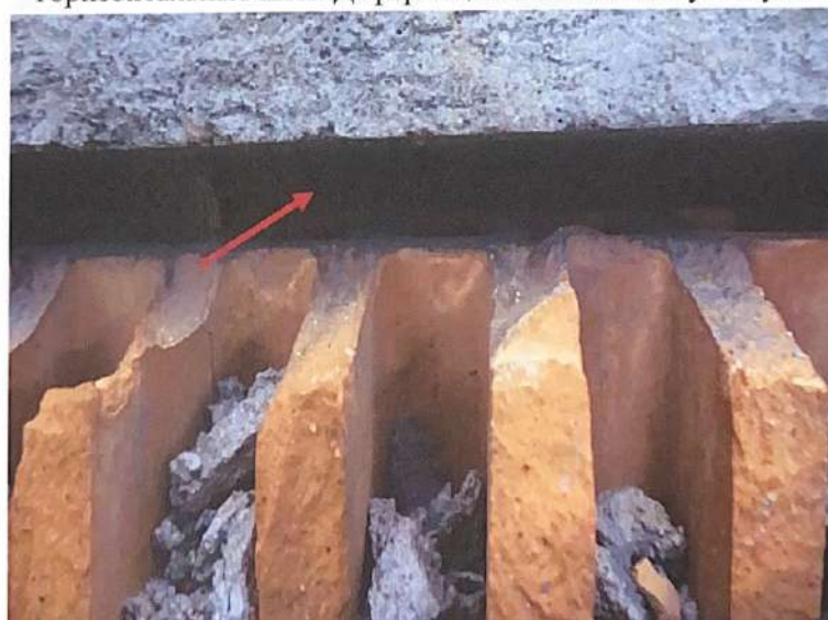
Фото 136. Секция 11. Фасад 2. Деформационный шов отсутствует – сквозное отверстие.
