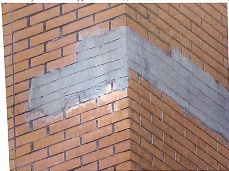
Фото 74. 810 Секция 10. Фасад 2. Места восстановления без признаков деформаций. Деформационный шов не выполнен.
