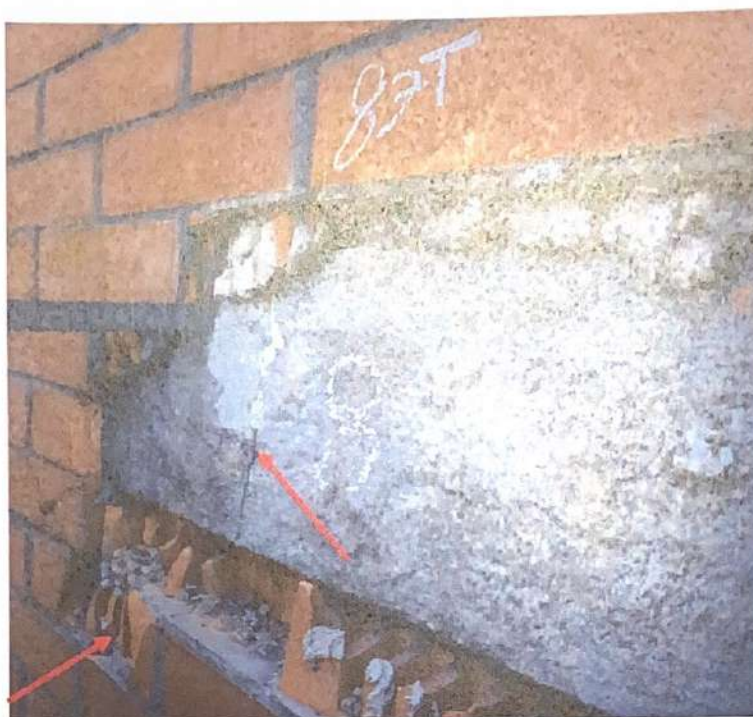
Фото 135. Секция 11. Фасад 2. Разрушение облицовки плиты перекрытия. Сверхнормативный свес опорного кирпича – 40мм. Сверхнормативные горизонтальные швы. Деформационный шов отсутствует.
