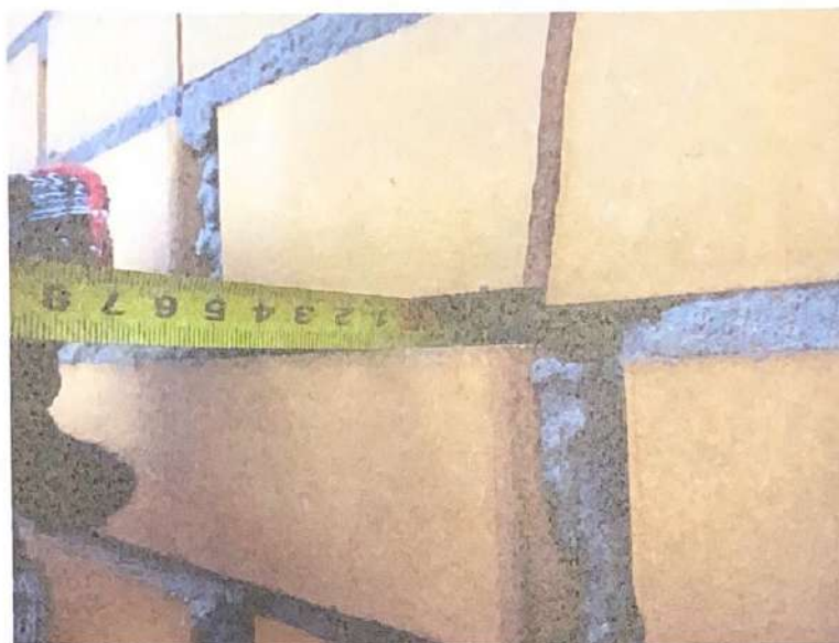
Фото 146. Секция 11/12. Фасад №2. Разрушение кладки по линии межсекционного деформационного шва. Смещение частей кладки наружу в двух плоскостях, сквозное разрушение швов и кирпича.
