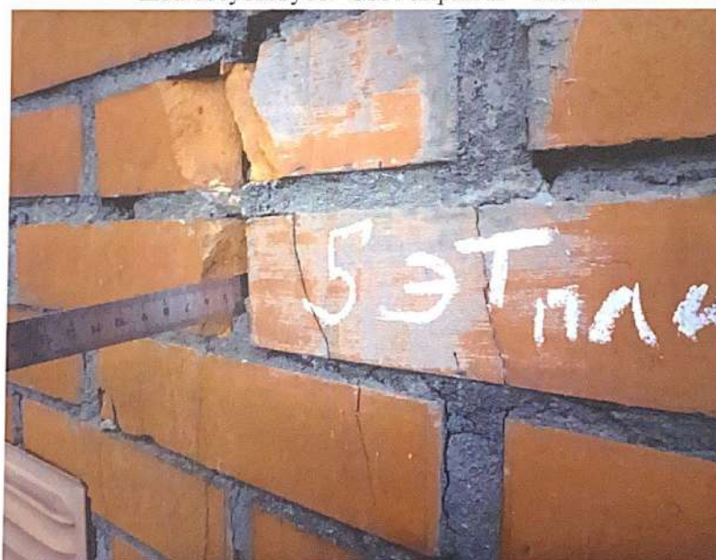
Фото 106. Секция 11. Фасад 2. Разрушения облицовки плиты. Деформационный шов отсутствует. Свес кирпича – 50мм.
