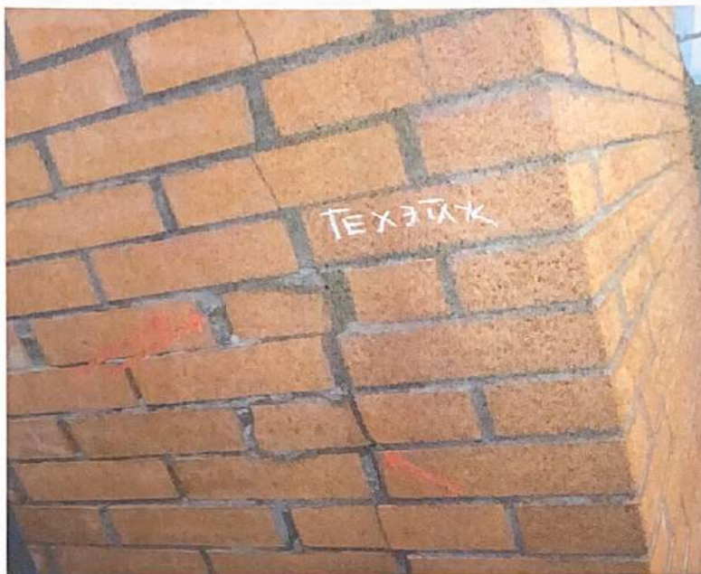
Фото 43. Секция 9. Фасад 1. Критическое повреждение наружной версты зоны примыкания металлоконструкций. Целостность кладки нарушена.
