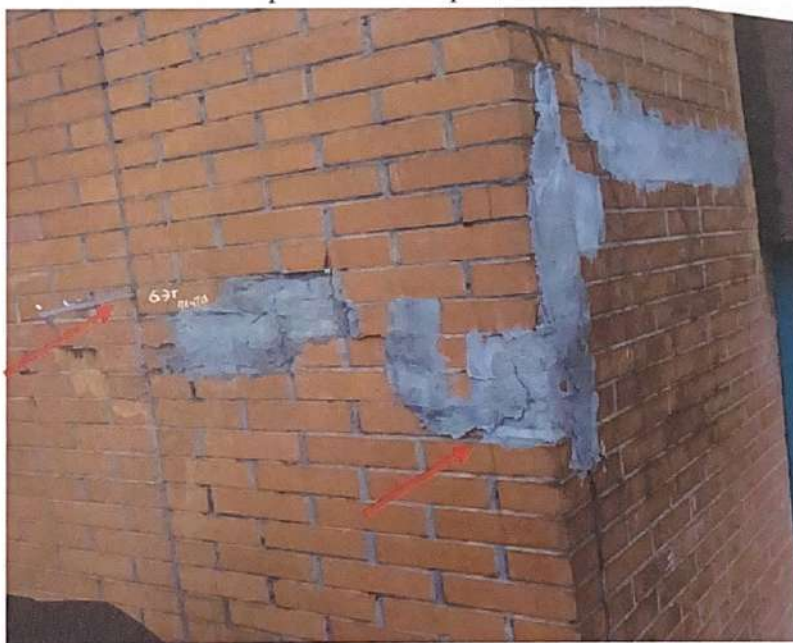
Фото 60. 8-й эт. Секция 9. Фасад 1. Раскрывшиеся трещины по месту восстановления облицовки торцов плит . Деформационный шов не выполнен. Обследование зоны плиты перекрытия – свес кладки достигает 72мм.
