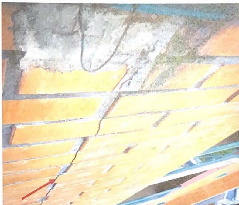
Фото 83. Секция 11. Фасад 2. Дефекты швов кладки-пустошовка. Вертикальные трещины в зоне примыкания металлоконструкций.
