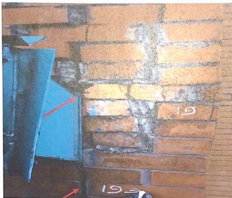
Фото 49. Секция 9. Фасад 1. Критическое повреждение наружной версты зоны примыкания металлоконструкций.
