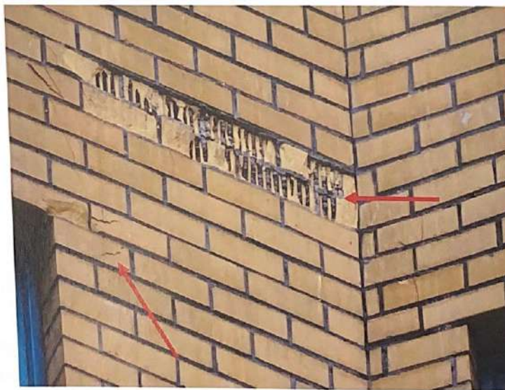
Фото 30. 781 Секция 8. Фасад 1. Разрушение облицовки торца плиты. Деформационные швы отсутствуют.
