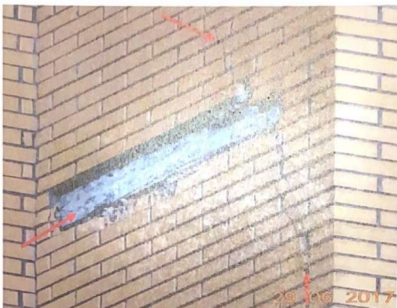
Фото 77. Секция 10. Фасад 2. Критические разрушения наружной версты и облицовки плиты. Деформационный шов не выполнен – сквозные отверстия. Трансэтажная вертикальная трещина.
