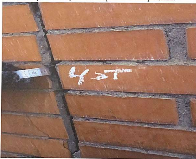
Фото 64. Секция 9. Фасад 1. Глубина трещины достигает 280мм.
