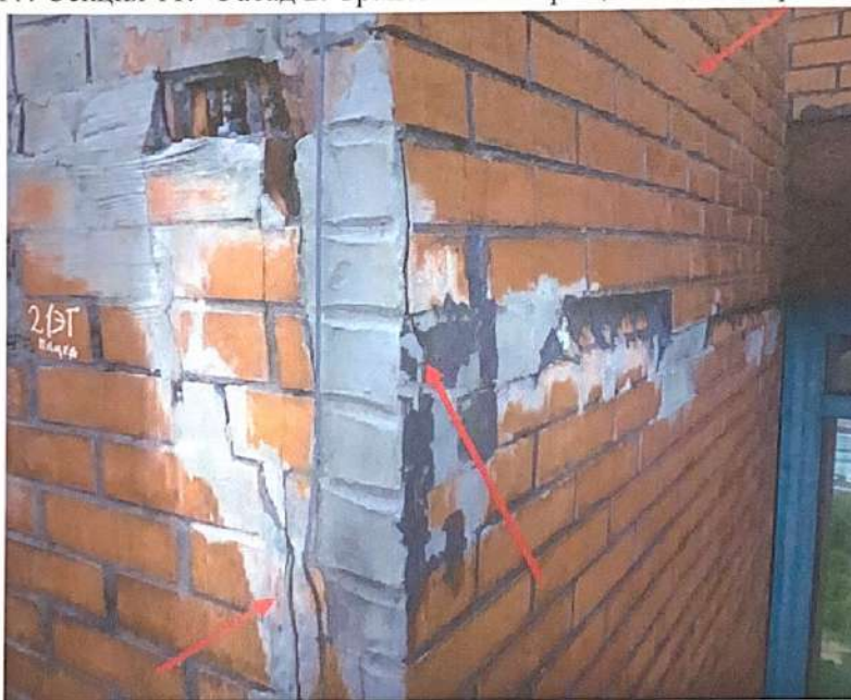
Фото 118. Секция 11. Фасад 2. Разрушение кладки по месту выполненного ремонта
