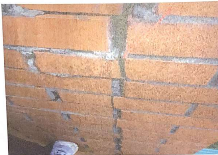
Фото 45. Секция 9. Фасад 1. Критическое повреждение наружной версты зоны примыкания металлоконструкций. Смещение отколовшейся части достигает 20мм.
