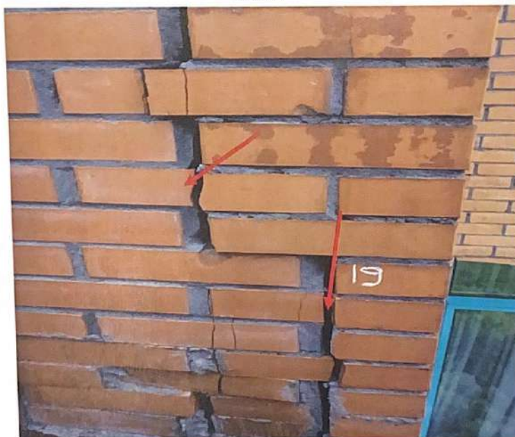
Фото 46. Секция 9. Фасад 1. Критическое повреждение наружной версты зоны примыкания металлоконструкций. Смещение отколовшейся части достигает 20мм.
