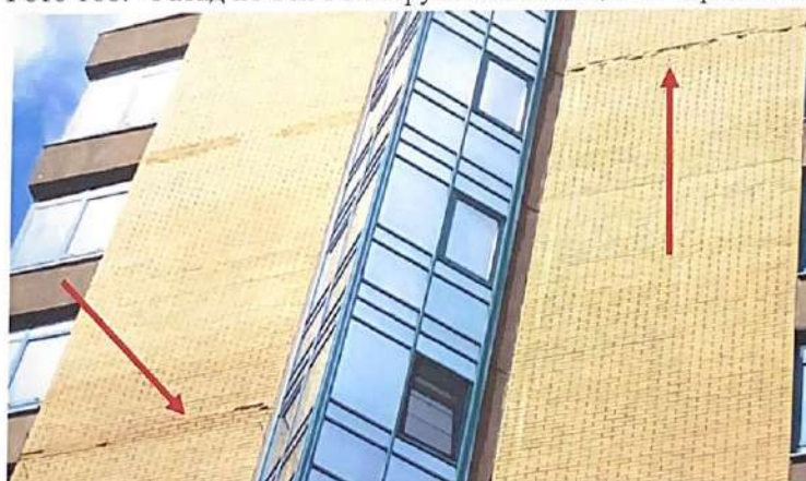
Фото 169. Фасад по оси F1. Разрушения облицовки торцов плит.
