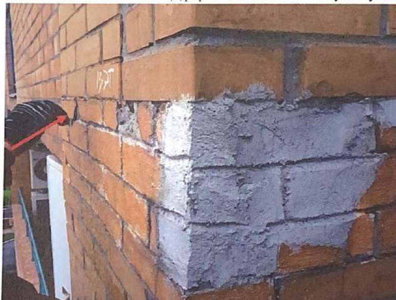
Фото 54. 13-й эт. Секция 9. Фасад 1. Места восстановления облицовки торцов плит. Деформационный шов не выполнен.
