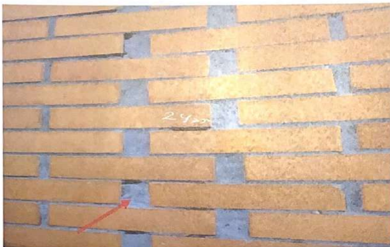
Фото 111. Секция 11. Фасад 2. Дефекты кладки – сверхнормативные вертикальные швы до 54мм., свидетельствующие о нарушении геометрии кладки. Пустошовка.
