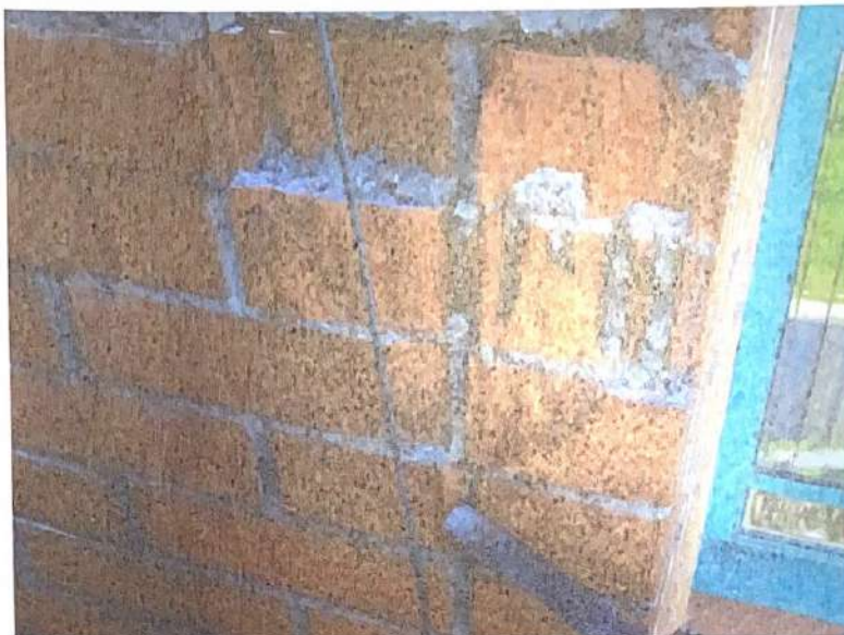
Фото 125. Секция 11. Фасад 2. Критические разрушения кирпича.
