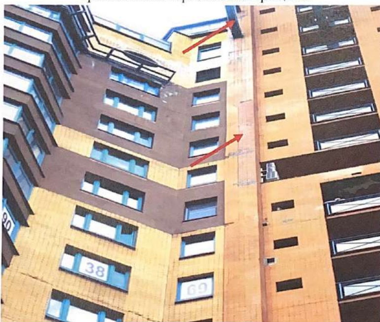
Фото 78. Секция 11. Фасад 2. Критические разрушения кладки в зоне примыканий металлоконструкций. Участок восстановления кладки наружной версты.
