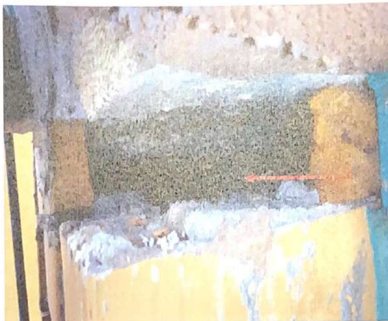
Фото 148. Секция 11/12. Фасад №2. Разрушение кладки по линии межсекционного деформационного шва. Сквозные проломы внутрь стеновой конструкции. Отсутствие деформационных швов. Полное отсутствие защиты от атмосферных воздействий.
