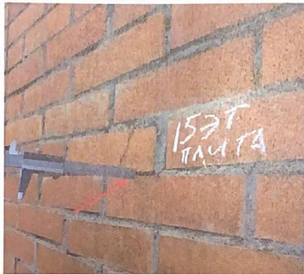
Фото 53. Секция 9. Фасад 1. Обследование зоны плиты перекрытия – свес кладки достигает 47мм. Деформационный шов отсутствует.
