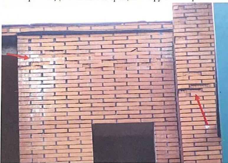
Фото 26. Секция 7. Фасад 1. Критические поверхностные разрушения кирпича подпарапетной зоны.
