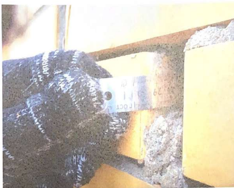
Фото 142. Секция 11/12. Фасад №2. Разрушение кладки по линии межсекционного деформационного шва.
