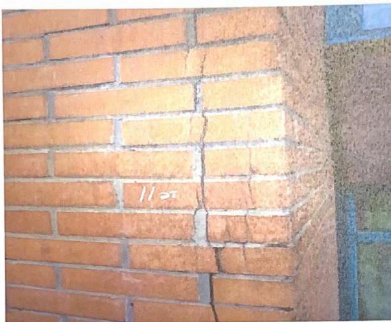
Фото 57. Секция 9. Фасад 1. Критическое повреждение наружной версты – вертикальная трещина с раскрытием 6мм.
