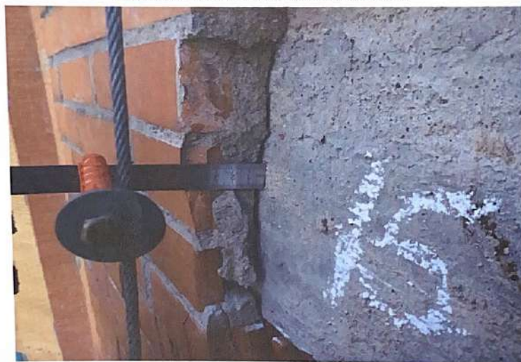
Фото 124. Секция 11. Фасад 2. Разрушение облицовки плиты. Свес плиты 65мм. по обеим плоскостям.
