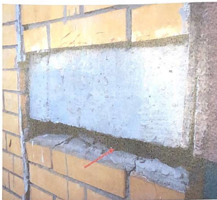
Фото 160. Секция 11/12. Фасад №2. Разрушение облицовки торца плит. Отсутствие деформационных швов. Полное отсутствие защиты от атмосферных воздействий.
