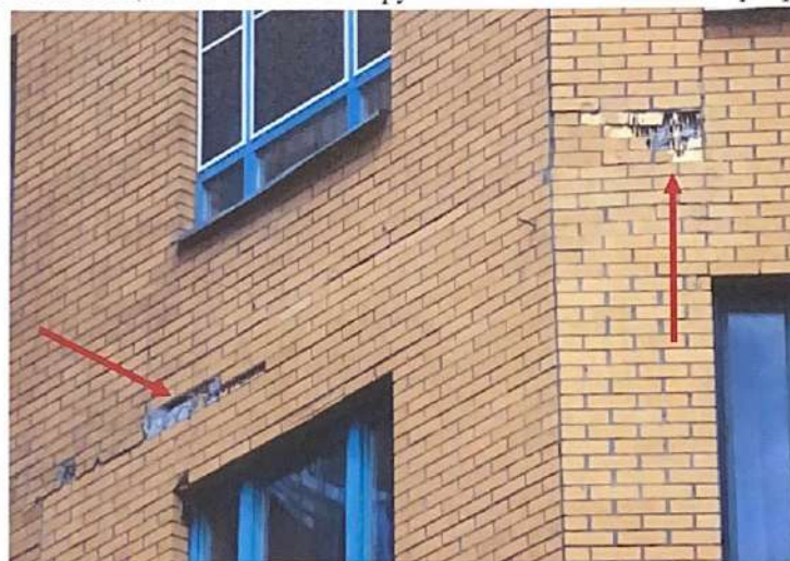
Фото 175. Секция 11. Ось E13. Разрушения по линиям плит перекрытия.
