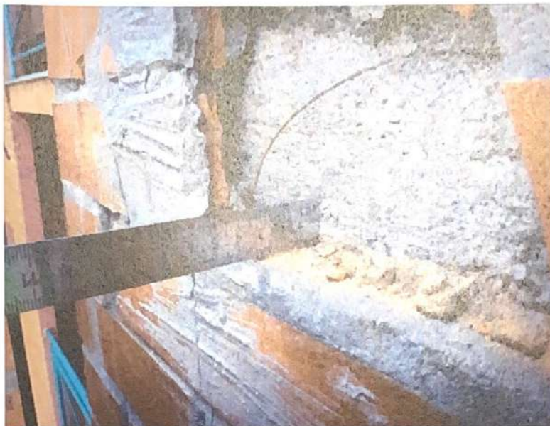
Фото 119. Секция 11. Фасад 2. Разрушение Облицовки плиты Свес кирпича — 45мм.
