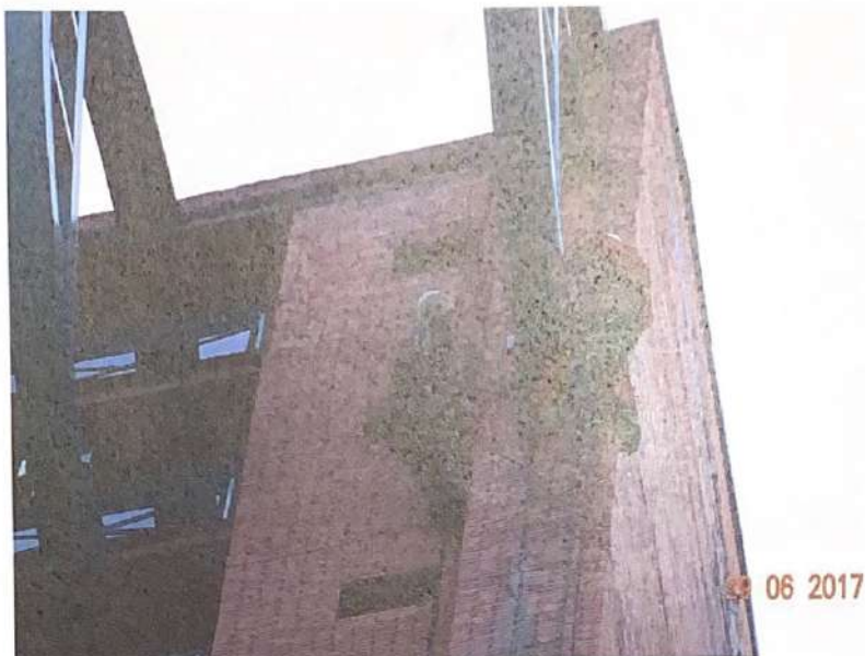
Фото 107. Секция 11. Фасад 2. Детальное обследование правой стороны подъездного выступа. Разрушения кладки в зоне металлоконструкций.
