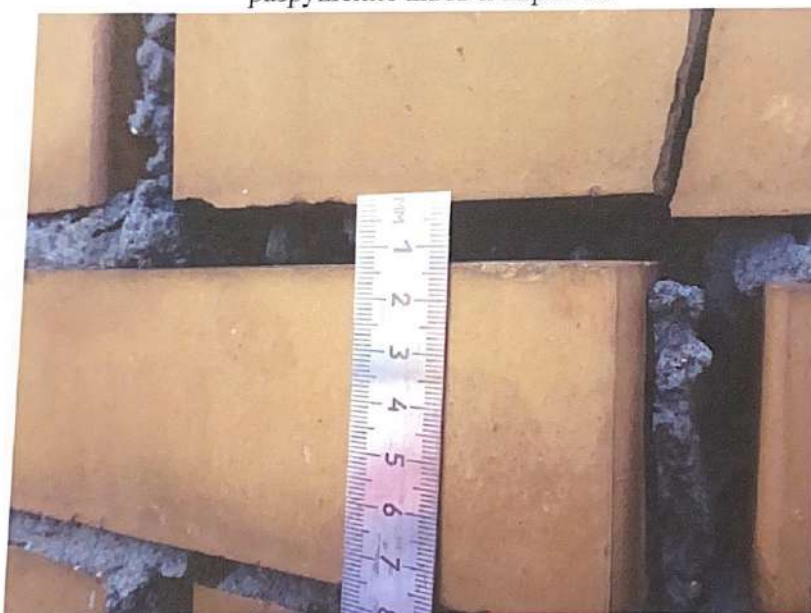
Фото 145. Секция 11/12. Фасад №2. Разрушение кладки по линии межсекционного деформационного шва. Смещение частей кладки наружу в двух плоскостях, сквозное разрушение швов и кирпича.
