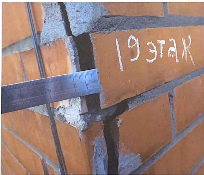
Фото 120. Секция 11. Фасад 2. Критическое разрушение кладки наружной версты.
