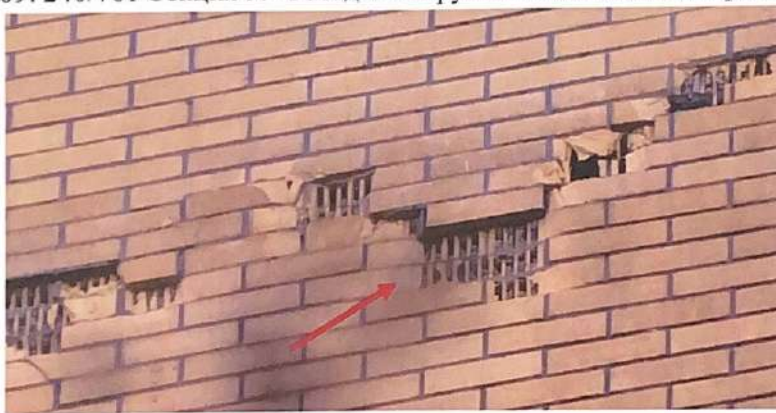
Фото 70. Секция 9. Фасад 1. Разрушения облицовки торца плиты.
