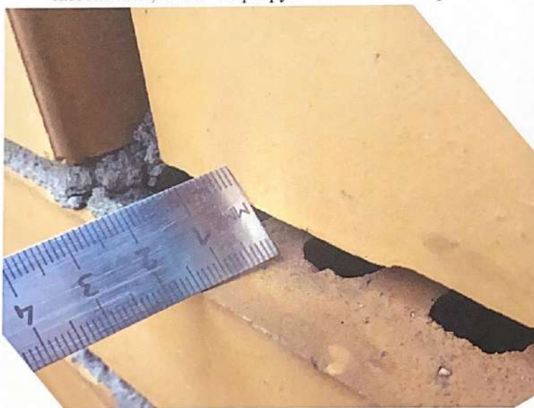
Фото 155. Секция 11/12. Фасад №2. Фасад №2. Линия разрушения кладки по линии межсекционного деформационного шва. Полное отсутствие защиты от атмосферных воздействий. Критическое смещение частей кладки наружу в двух плоскостях-до 20мм.
