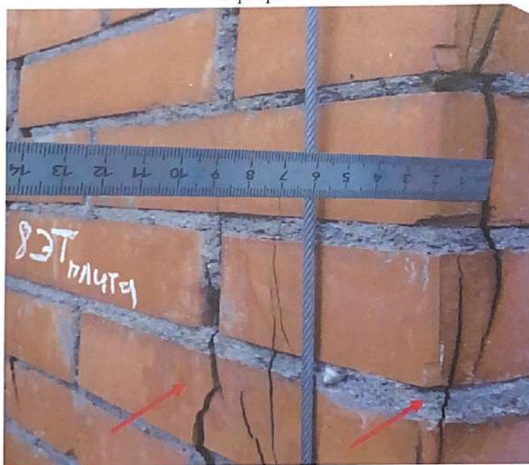
Фото 134. Секция 11. Фасад 2. Разрушение кладки по месту плиты перекрытия.
