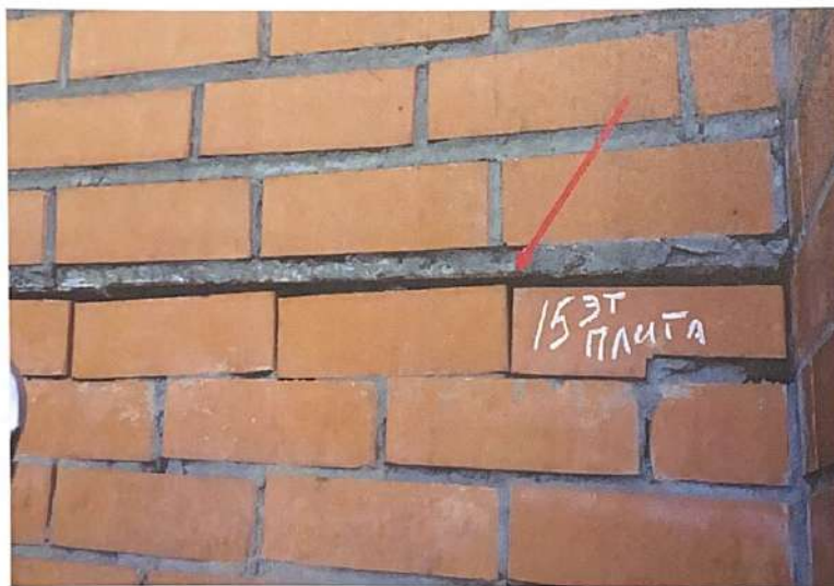
Фото 126. Секция 11. Фасад 2. Дефекты облицовки плиты – сквозные отверстия.
