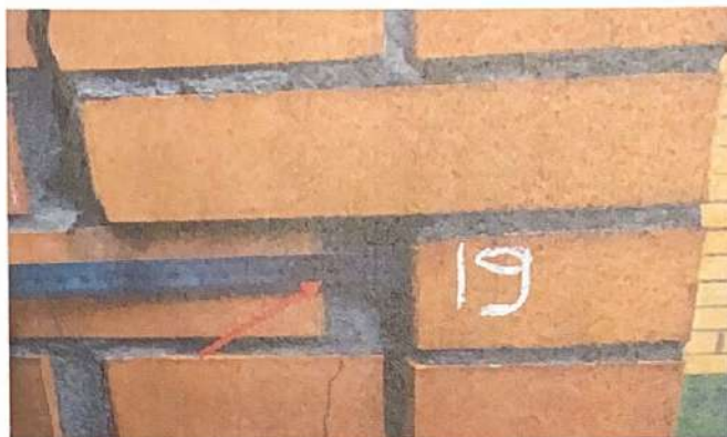
Фото 47. Секция 9. Фасад 1. Критическое повреждение наружной версты зоны примыкания металлоконструкций. Смещение отколовшейся части достигает 15мм.
