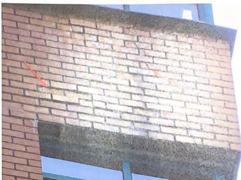
Фото 25. 773 Секция 7. Фасад 1. Критические поверхностные разрушения кирпича. Диагональные трещины наружной версты.
