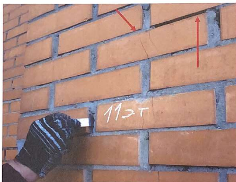
Фото 128. Секция 11. Фасад 2. Сквозная пустошовка.
