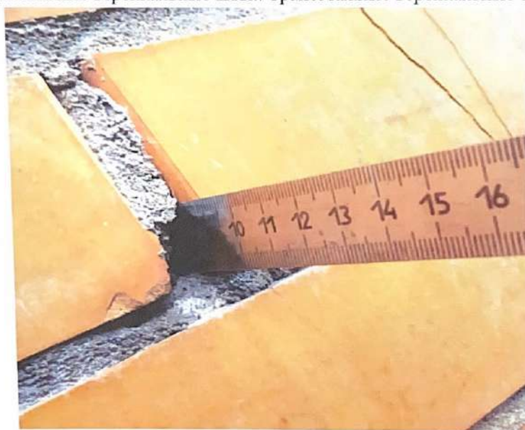
Фото 88. Секция 11. Фасад 2. Дефекты швов кладки-пустошовка.
