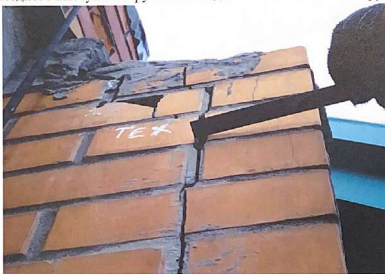
Фото 108. Секция 11. Фасад 2. Правый угол. Вертикальная трещина с раскрытием до 6мм.
