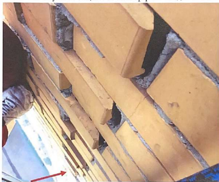
Фото 151. Секция 11/12. Фасад №2. Разрушение кладки по линии межсекционного деформационного шва. Полное отсутствие защиты от атмосферных воздействий. Критическое смещение частей кладки наружу в двух плоскостях, сквозное разрушение швов и кирпича.
