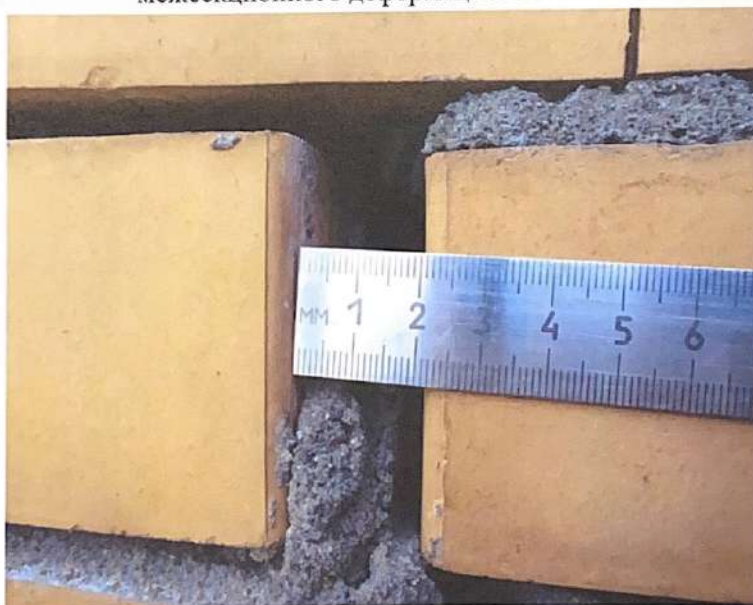
Фото 143. Секция 11/12. Фасад №2. Разрушение кладки по линии межсекционного деформационного шва. Смещение частей кладки наружу в двух плоскостях, сквозное разрушение швов и кирпича.
