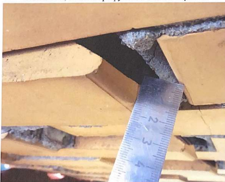
Фото 153. Секция 11/12. Фасад №2. Критическое смещение частей кладки наружу в двух плоскостях, сквозное разрушение швов и кирпича.
