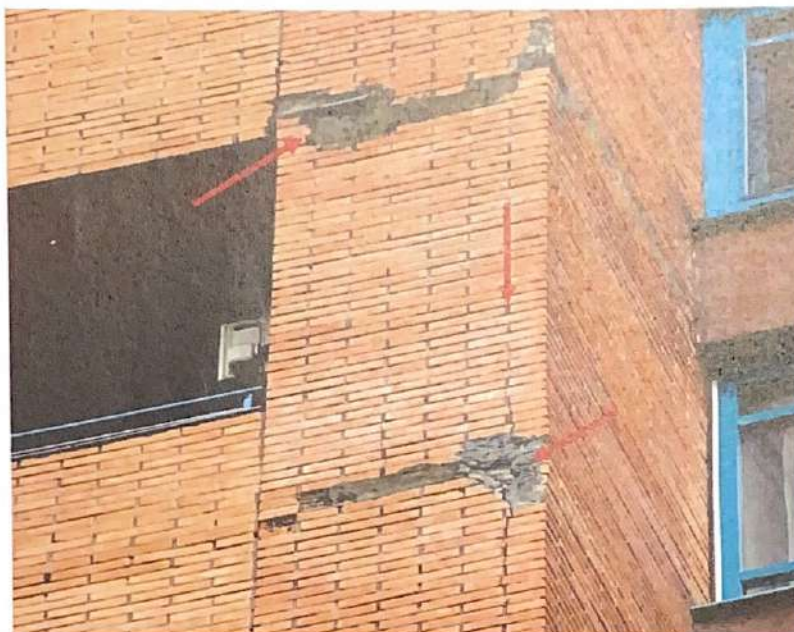
Фото 59. 800 Секция 9. Фасад 1. Разрушения зоны облицовки плит перекрытия. Трансэтажная трещина.
