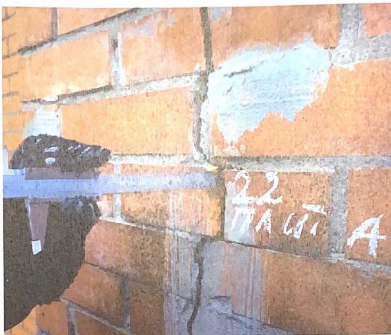
Фото 117. Секция 11. Фасад 2. Трансэтажная трещина. Свес кирпича - 46мм.
