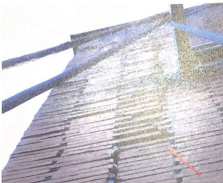
Фото 152. Секция 11/12. Фасад №2. Разрушение кладки по линии межсекционного деформационного шва. Полное отсутствие защиты от атмосферных воздействий. Критическое смещение частей кладки наружу в двух плоскостях, сквозное разрушение швов и кирпича.
