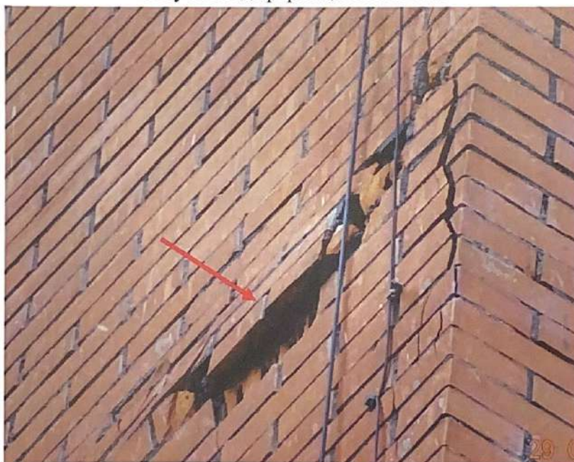
Фото 76. 147 Секция 10. Фасад 2. Критические разрушения фасада. Трансэтажная вертикальная трещина. Разрушение облицовки торца плиты. Отсутствие деформационного шва.
