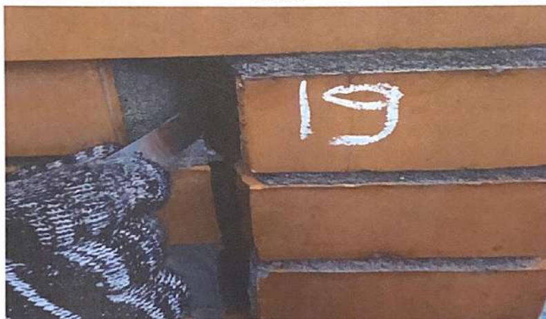
Фото 48. Секция 9. Фасад 1. Критическое повреждение наружной версты зоны примыкания металлоконструкций. Глубина трещины достигает 280мм. Наружная верста боковой плоскости не имеет нормативной опоры на плиту перекрытия.
