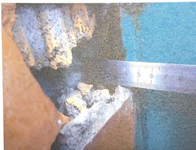
Фото 115. Секция 11. Фасад 2. Правый угол. Разрушение кладки в зоне примыкания металлоконструкций.
