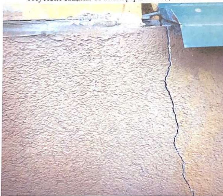
Фото 159. Секция 11/12. Фасад №2. Трещина наружной версты от угла окон.
