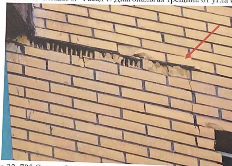
Фото 32. 785 Секция 8. Фасад 1. Разрушение облицовки торца плиты. Диагональная трещина от угла окна. Деформационные швы отсутствуют.
