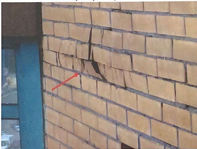
Фото 102. 13-й этаж. Секция 11. Фасад 2. Участок левой подъезда. Разрушения облицовки плиты. Деформационный шов отсутствует. Пустошовка.
