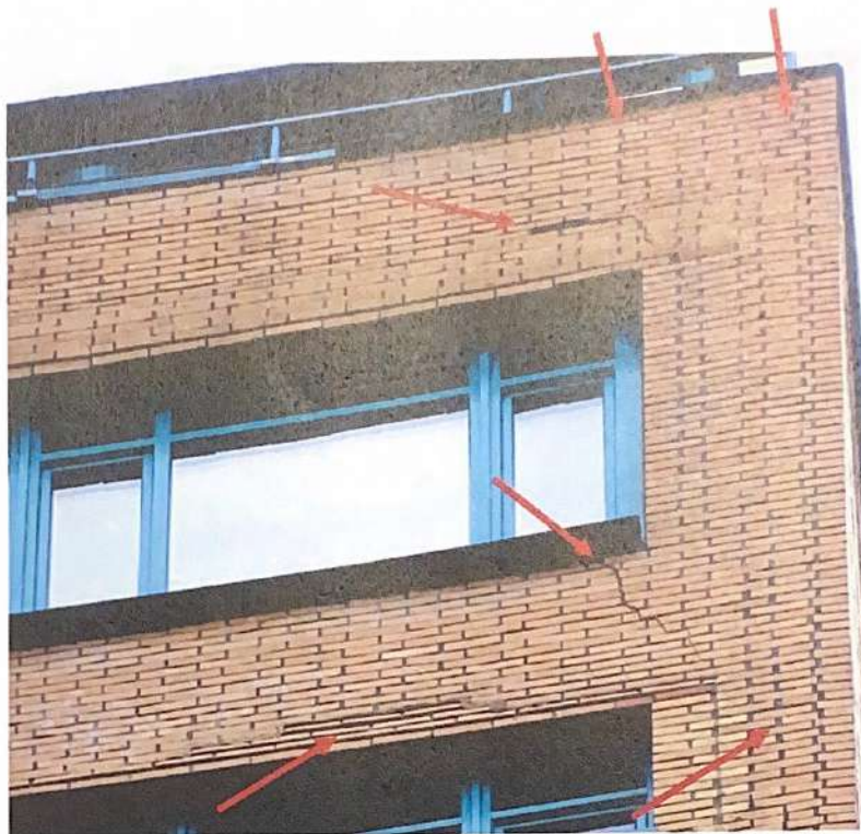
Фото 71. 809 Секция 10. Фасад 2. Межсекционный деформационный шов не доходит до верха здания – причина разрушения вышележащей кладки. Диагональные трещины. Разрушение кладки над оконными балками.
