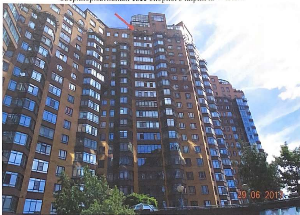
Фото 177. Секции 10-12. Дворовой фасад. Разрушения кладки по линии межсекционного (секции 10/11) деформационного шва.
