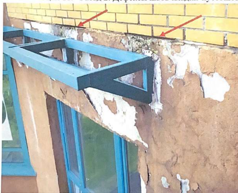
Фото 86. Секция 11. Фасад 2. Порезание отделочных слоев- отсутствие защиты от замокания конструкций.
